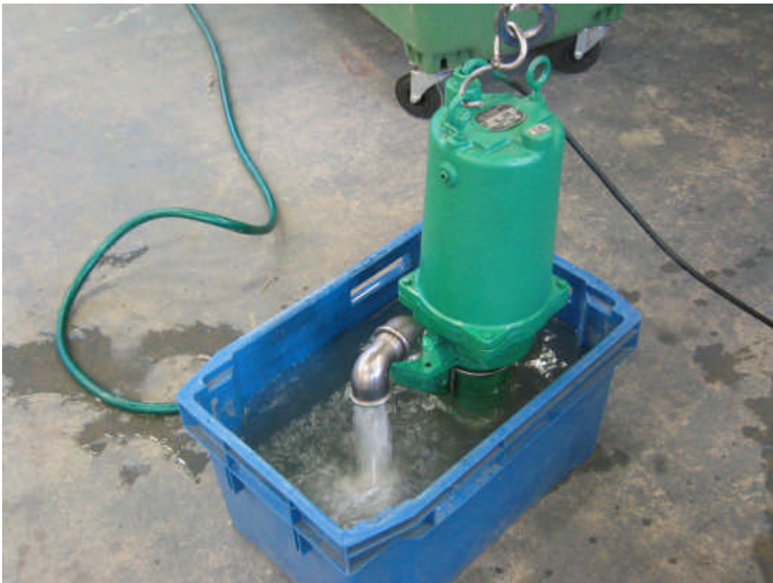
Kuva 12. Huollettu pumppu koekäytössä. Öljyntäyttötulppa näkyy moottorin kyljessä.
